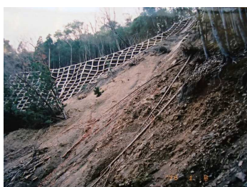
上切原側の大規模な崩落
