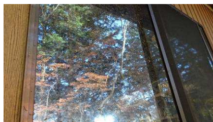
窓ガラスにゴミ固着
