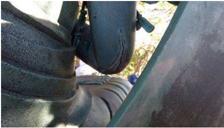
右肘部の亀裂損傷(古い)
