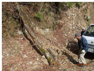
通行支障の倒木切除
