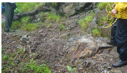
木橋傍の崩壊箇所
