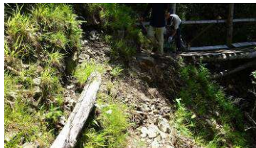
捲き道の崩落箇所
