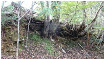
崩れが進んだ小屋前の斜面
