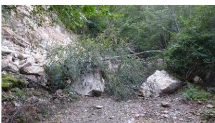
池郷林道の崩落現場
