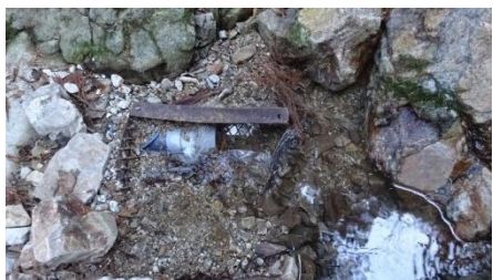
土砂で埋まった取水口
