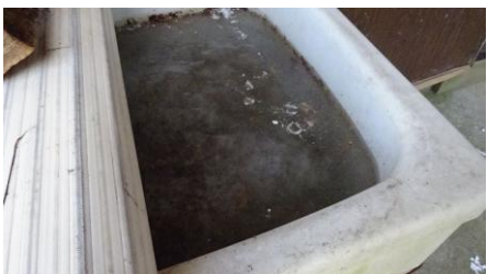
玄関横の雨水槽
