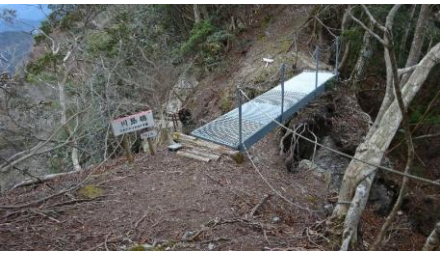
川島橋、異常なし
