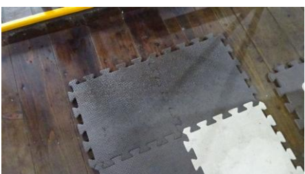
雨漏りで濡れる
