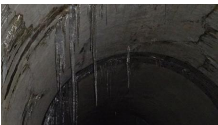
白谷トンネルのツララ
