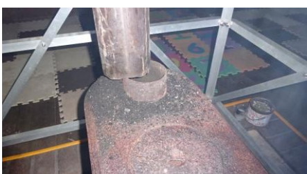
煙突が外れていた
